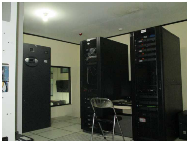
Gambar 2. Ruang Server Pustik Universitas Mataram
