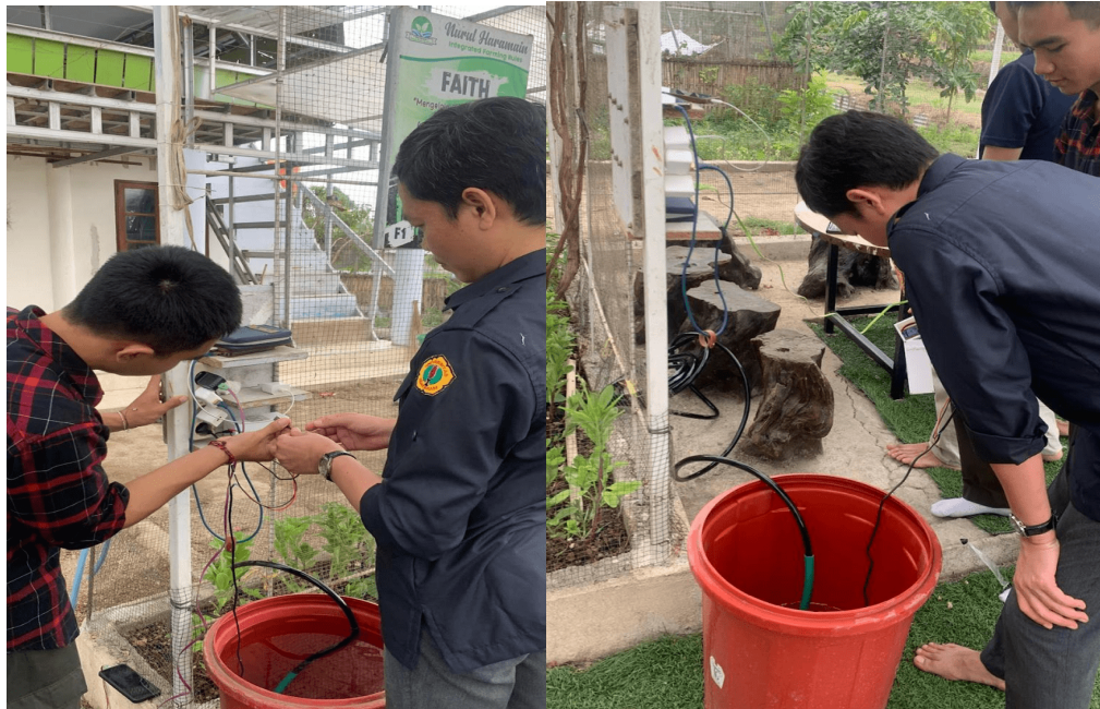
Gambar 4. Instalasi Sistem Irigasi Tetes
