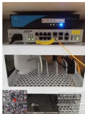
Gambar 3. Perangkat Jaringan Terpasang
