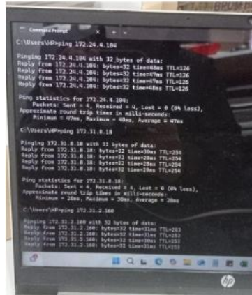
Gambar 4. Instalasi Perangkat Jaringan
